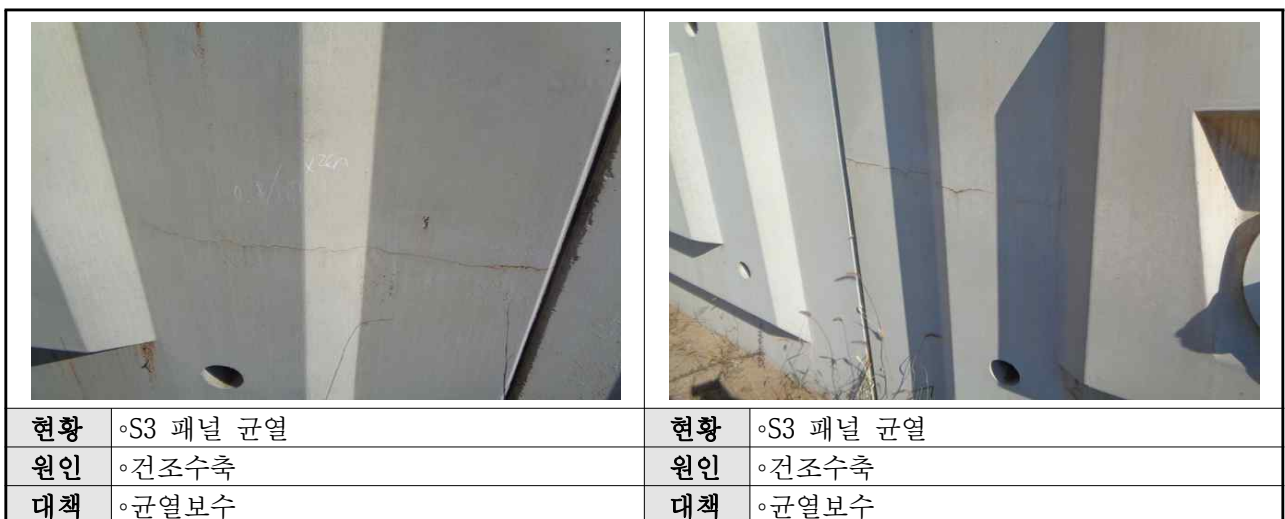
【사진 3.3】 옹벽 전면부 주요 손상 및 현황
